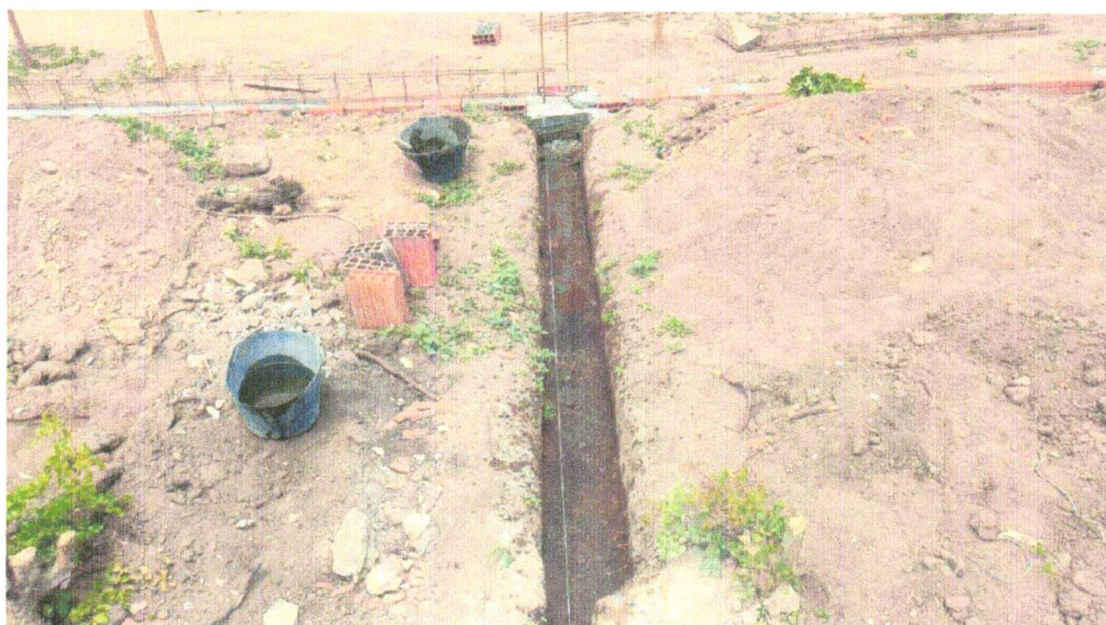
FOTO 10 - LASTRO DE CONCRETO MAGRO, APLICADO EM BLOCOS DE COROAMENTO OU SAPATAS, ESPESSURA DE 3 CM
