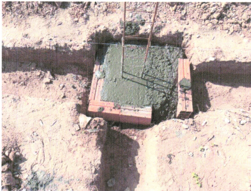
FOTO 15 - COMPOSIÇÃO REPRESENTATIVA) EXECUÇÃO DE ESTRUTURAS DE CONCRETO ARMADO, PARA EDIFICAÇÃO HABITACIONAL UNIFAMILIAR TÉRREA (CASA EM EMPREENDIMENTOS), FCK = 25 MPA. AF_01/2017
