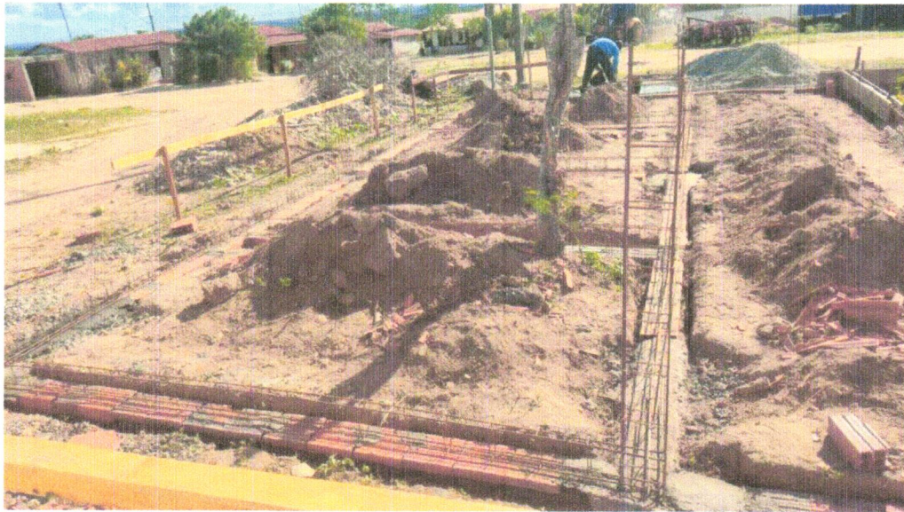
Foto 19 - LASTRO DE CONCRETO MAGRO, APLICADO EM BLOCOS DE COROAMENTO OU SAPATAS, ESPESSURA DE 3 CM
